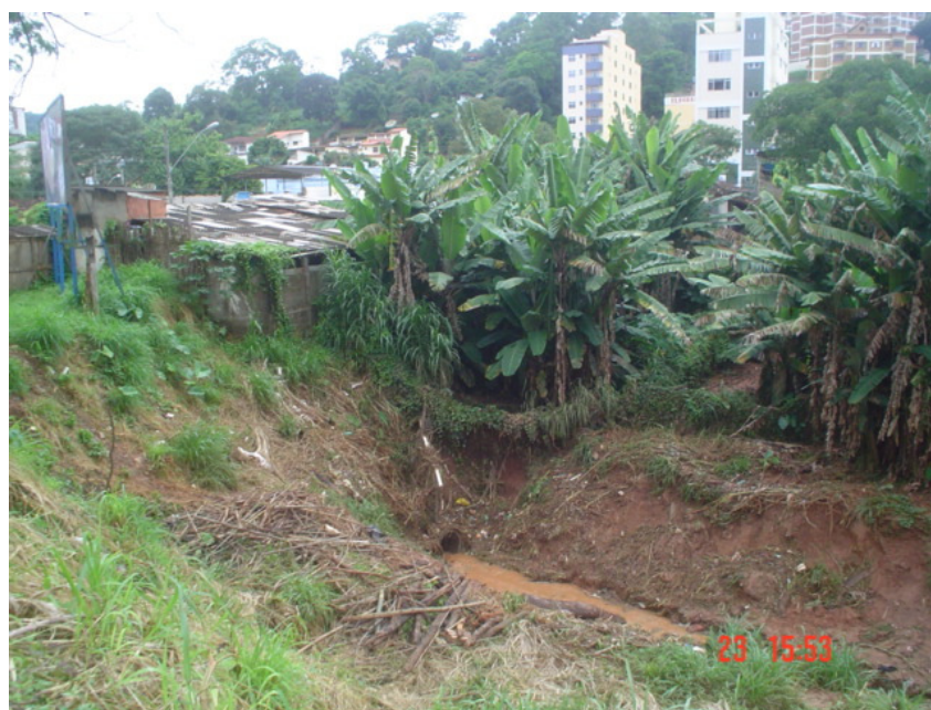
FIGURA 46 – Estrangulamento da travessa Purdue (duas manilhas de 1m de diâmetro)
