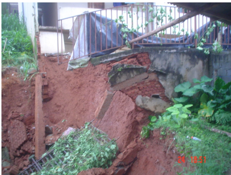
FIGURA 42 – Vista parcial de uma cratera causada pelo rompimento da canalização do córrego Bom Jesus
