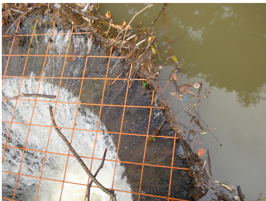
FIGURA 27 – Vista parcial da grade de retenção de resíduos fixada no vertedouro
