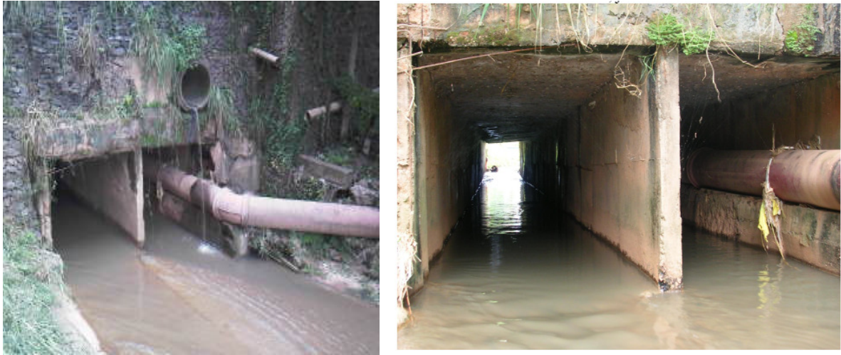
FIGURA 34 – Galeria por onde passa o ribeirão São Bartolomeu construída sob a Travessa Tancredo Neves
