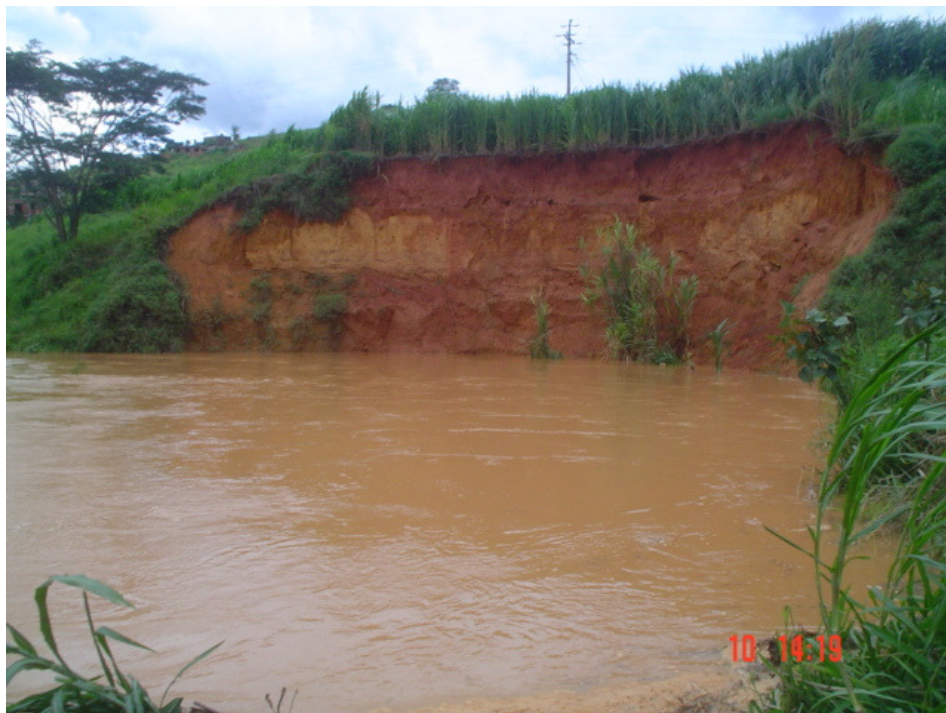
FIGURA 35 – Desmoronamento da margem do ribeirão São Bartolomeu causado pela remoção da mata ciliar e ocupação irregular das áreas de APP's
