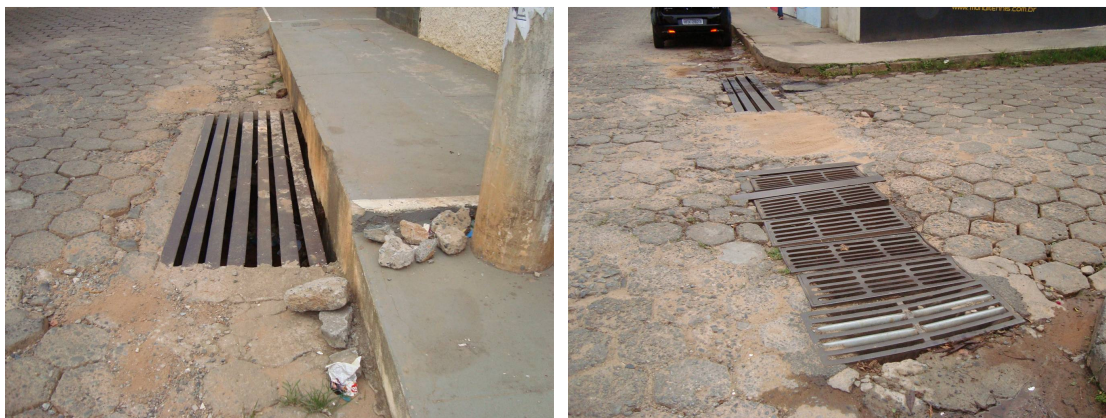
FIGURA 57 – Aspecto geral de "bocas de lobo" estrutura de drenagem de grande tamanho
