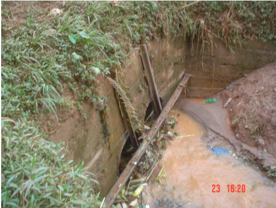
FIGURA 49 – Área de alagamento localizada atrás do Shopping da Moda (Secção circular – 1m de diâmetro e secção quadrada – 2m X 2m)
