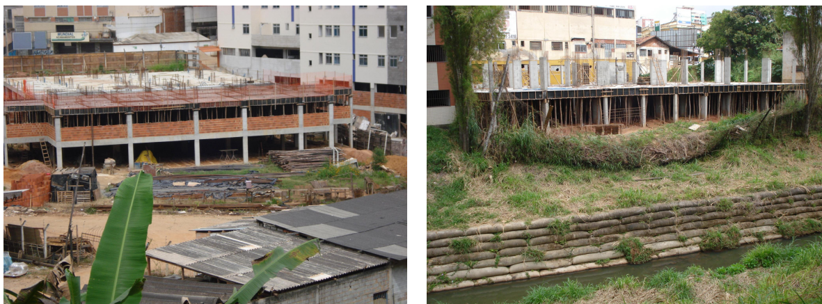
FIGURA 30 – Vista parcial de construções localizadas às margens do ribeirão São Bartolomeu, em desacordo com a legislação em vigor e que apesar disto sofre forte especulação imobiliária
