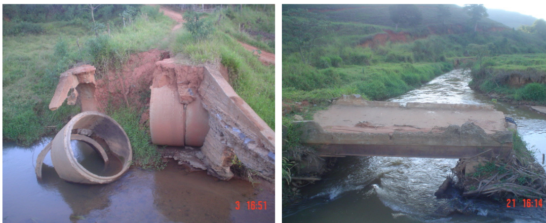
FIGURA 61 – Pontes na zona rural destruídas pelo pico de vazão
