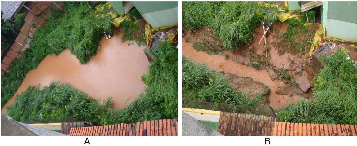
FIGURA 52 – Aspecto visual da área alagada localizada atrás do Shopping da Moda (A) e a mesma área após a inundação (B)
