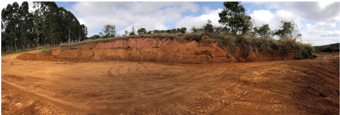
Figura 66 - Vista parcial da área de empréstimo de solo em que se pretende implantar o novo aterro sanitário com área de vegetação que passará pelo processo de supressão.
